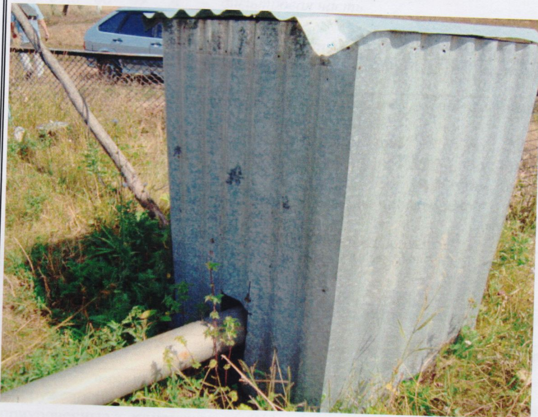
Рис.3 Павильон над устьем скважины №1. Ограждение первого пояса ЗСО
